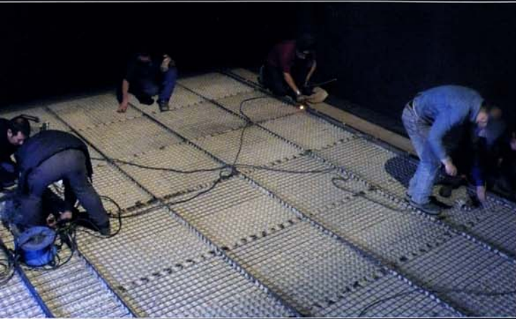
El reto ha exigido un trabajo de colocación muy técnico y depurado a cargo de la empresa Colocaciones Especiales.
